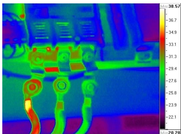
Рисунок 21. Пример термограммы контактных соединений с температурной шкалой
