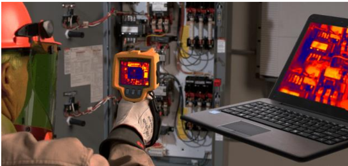
Рисунок 20. Пример проведения тепловизионного контроля электрошкафа
